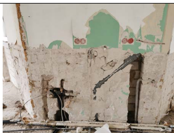
Nasse Wände und Moder. Der 60 cm-Hochwasserstand ist noch sichtbar in der Stolberger Tafel e.V. in der Eifel.
