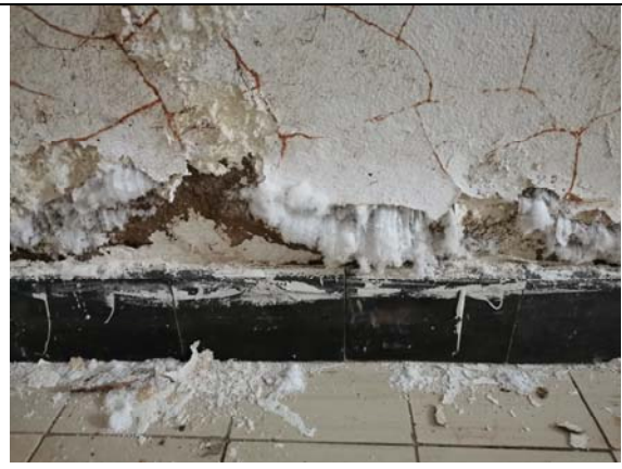
Feuchtigkeit arbeitet in den Wänden in der Kaller Tafel.
